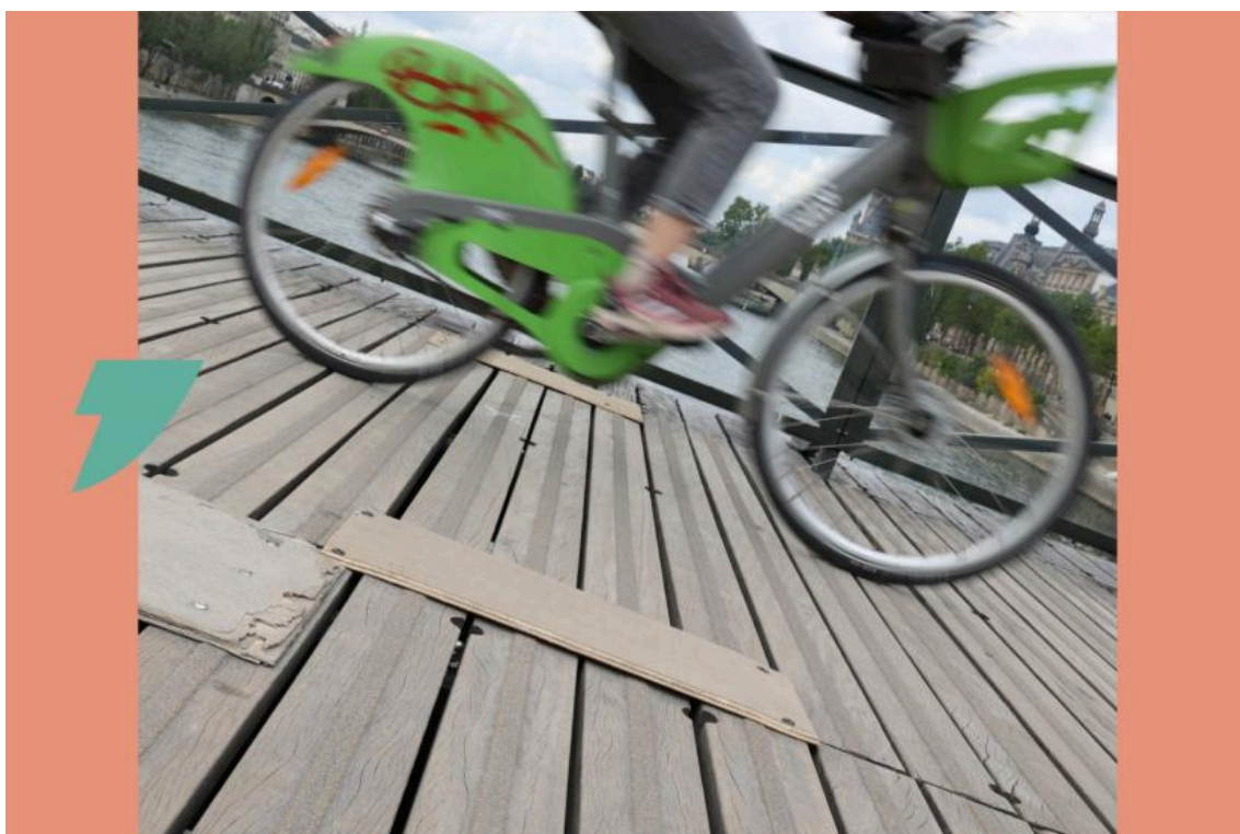
Des travaux de consolidation du plancher du pont des Arts sont en cours. (Pierrick de Morel )
